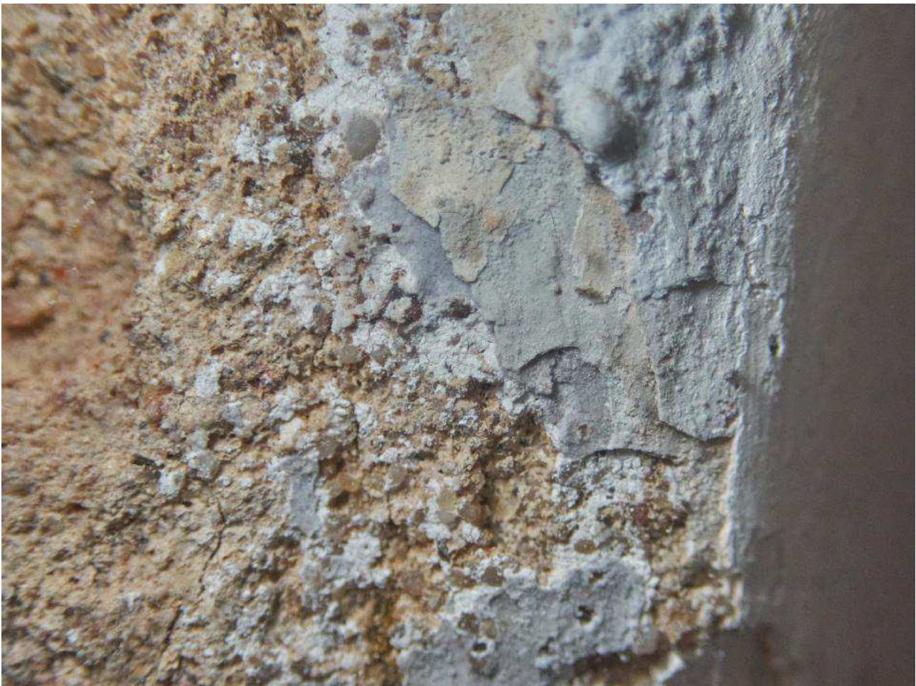
WARSTWY FARB W MIEJSCACH DESTRUKCJI TYNKU W KRUCHCIE. WARSTWA NAJSTARSZA TO POBIAŁA
