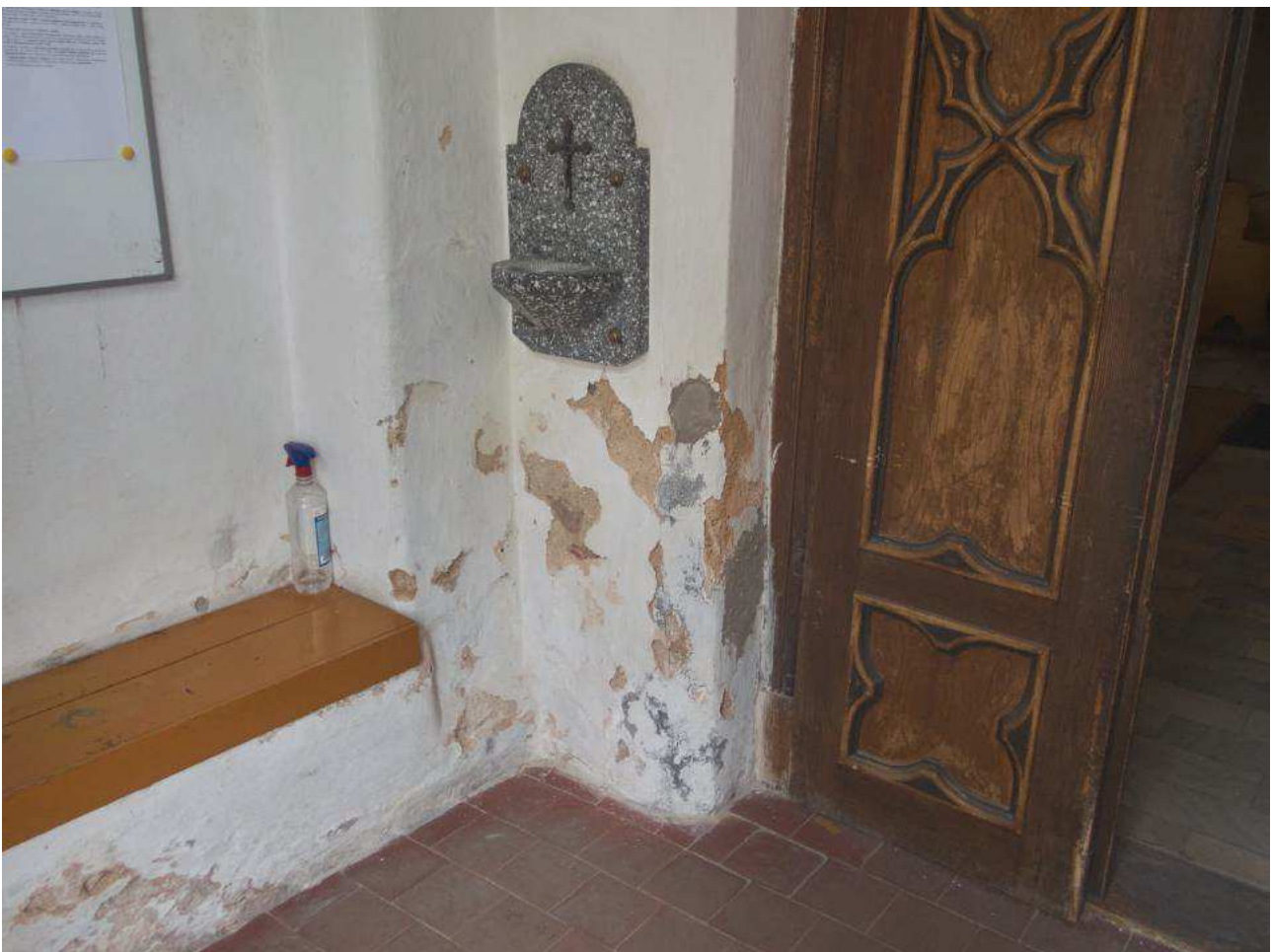
ZNISZCZONE TYNKI W KRUCHCIE
