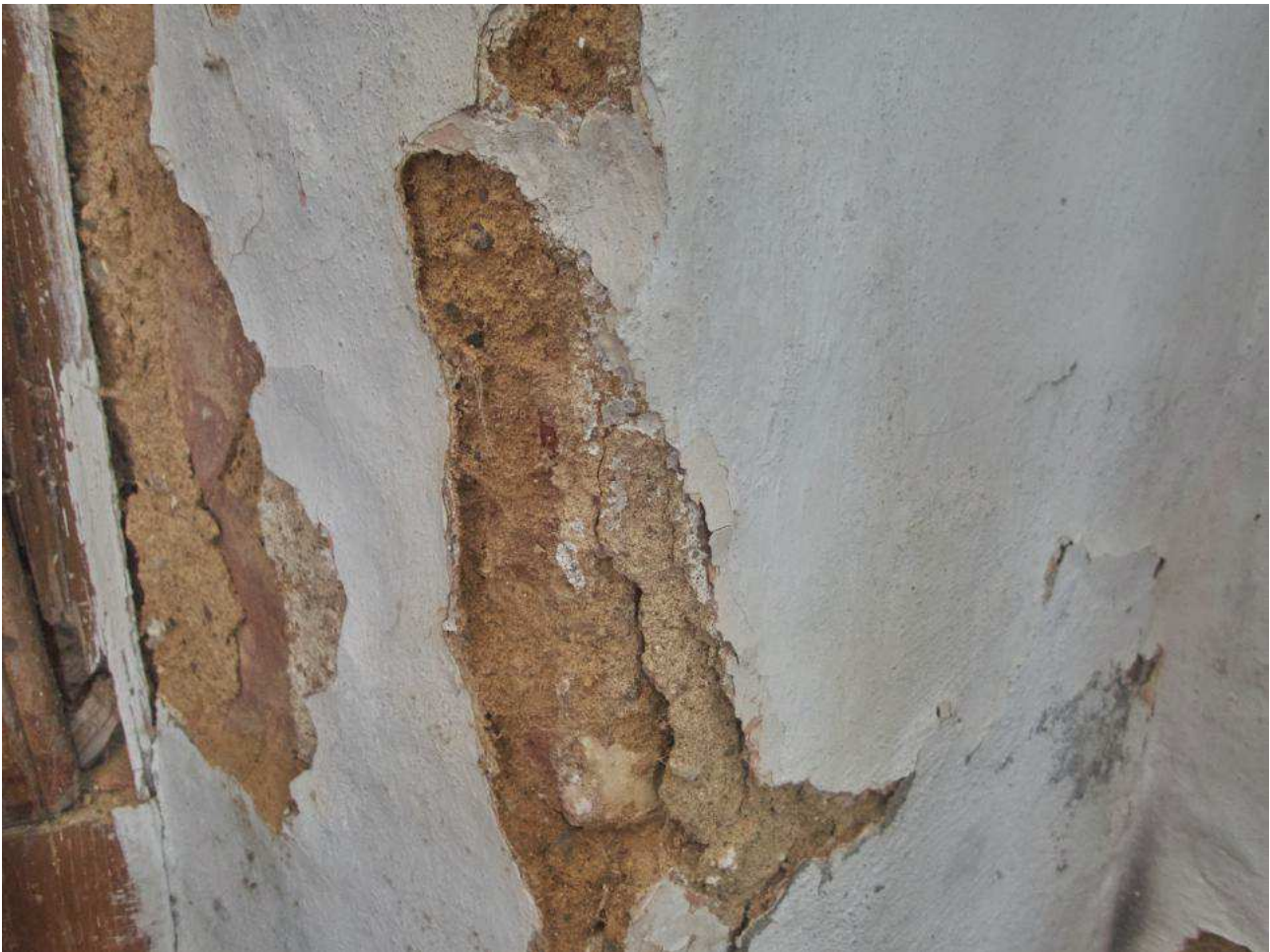
ZNISZCZONE TYNKI W KRUCHCIE
